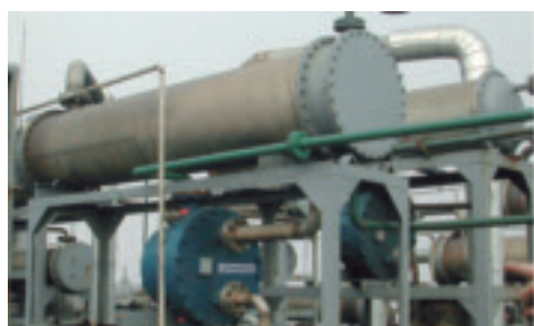
660 кВт конденсатор бензола, тип PSHE 5HH-126/1/1
